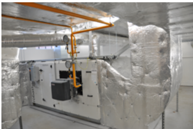
kotelna Roškotovo divadlo 2014
