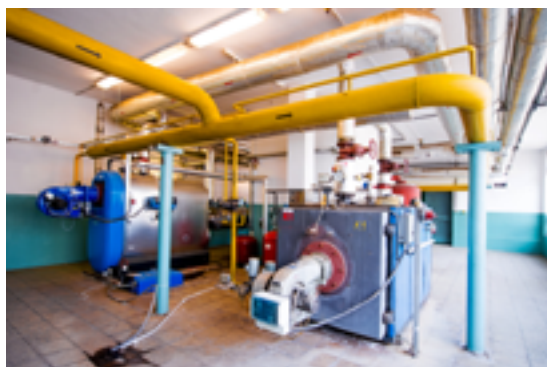
kotelna po rekonstrukci
