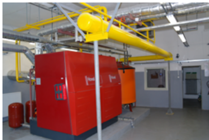
kotelna Poříční 453-interiér 2015
