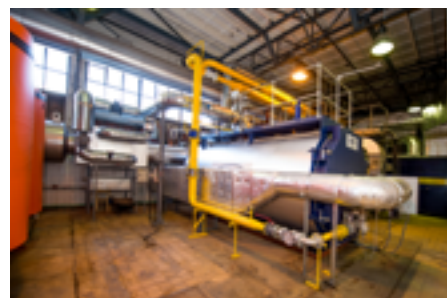
kotelna Mazánkova 75 po modernizaci 2014
