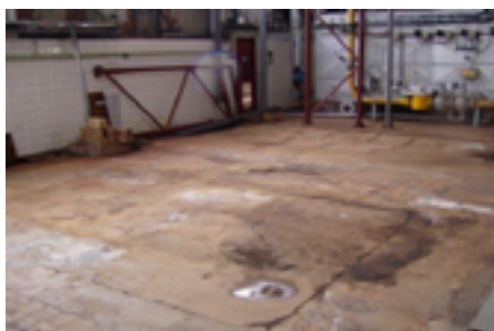
kotelna Mazánkova 75 před modernizací
