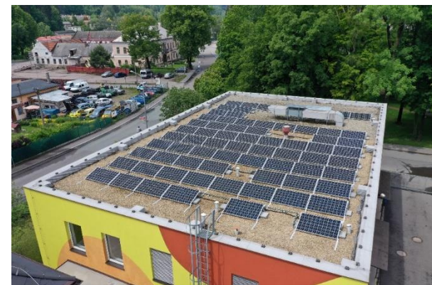
Fotovoltaické panely na ZŠ Třebovská
