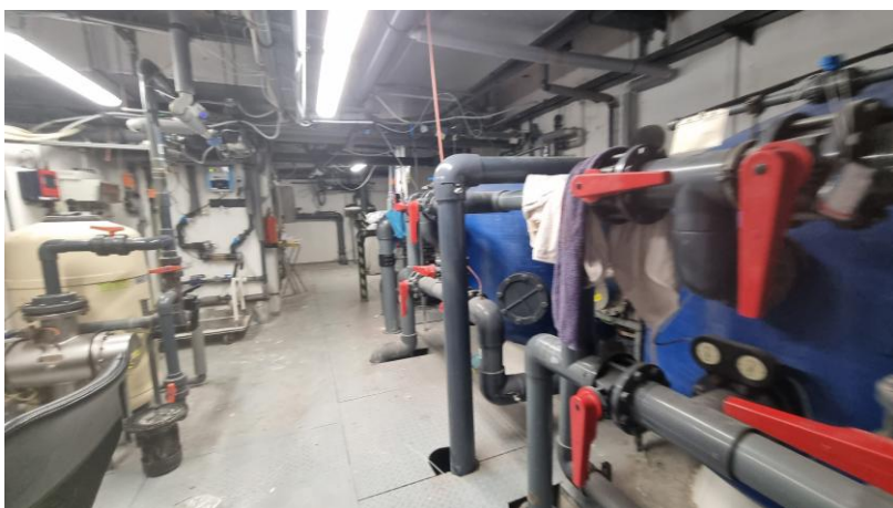
Obrázek 13 - Fotografie technického zázemí bazénu (zdroj: autor)
